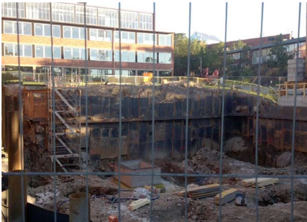
Fig. 3. Foto taget från den norra sidan av schakten. Till vänster i bilden har man sprängt ut berg och här syns nu att ett antal av rören i sponten hänger fritt i luften. Hammarbandet är inte kontinuerligt utan man kan tydligt se skarvar. Man har inte heller täckt väggen med plåtar utan det finns allt för stora hål där jord och stenar kan rasa ner över arbetande personal. Nu kan man se att schaktväggen börjar luta in mot schakten.
