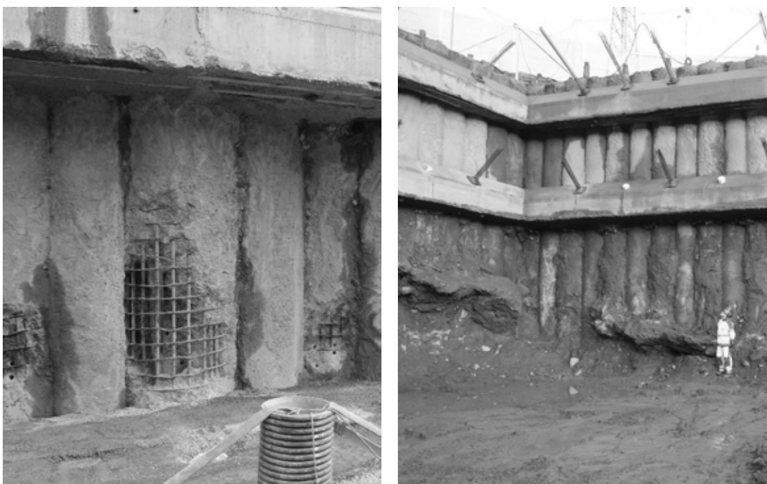
Figur 8. Bilden till vänster visar en betongskada mitt på väggen. Bilden till höger visar överförbruk av betong i övergången mellan lera och morän.
