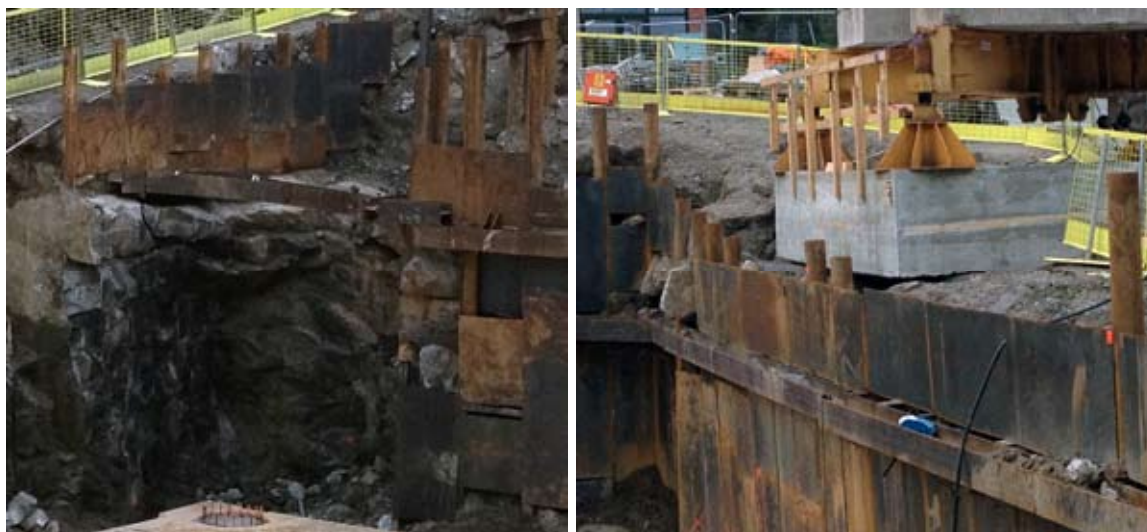
Fig. 5. A) Otillräckligt försök till förstärkning av den kraftigt deformerade sponten. Noterbart är det löst stenblock som ligger 5-6 m över schaktbotten. B) Stora markrörelser under kranfundamentet, en kraftigt inåtlutande spont med en felaktigt utförd hammarbandsskarv.
