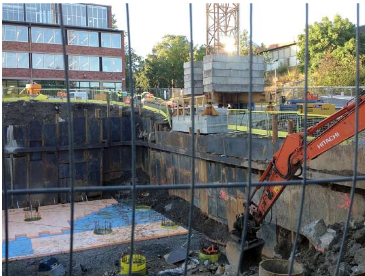
Fig. 4. Här syns tydligt att spontväggen lutar kraftigt. Spontväggen till vänster i bilden lutar dock ännu mer. I bilden kan man se stora marksättningar under kranfundamentet.
