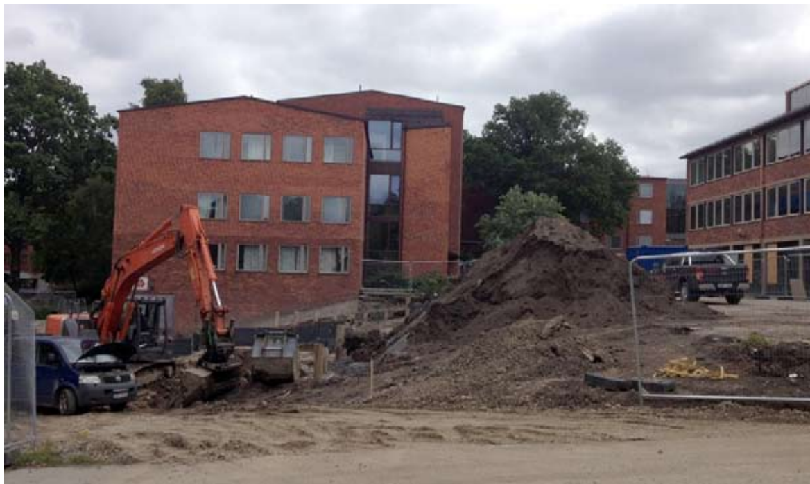
Fig. 1. Strategisk placering av schaktmassor alldeles utanför de installerade rören för sponten. Grävmaskinen i bilden schaktar innanför rörsponten som går strax till höger om skopan i bilden.
