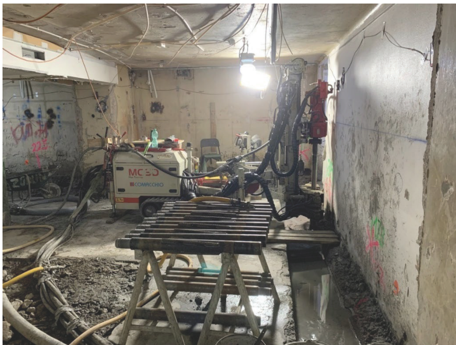
Figur 4 – Comacchio MC 3D, står redo för tillverkning av jetpelare. Observera diket längs fundament för lättare hantering av returflöde.
