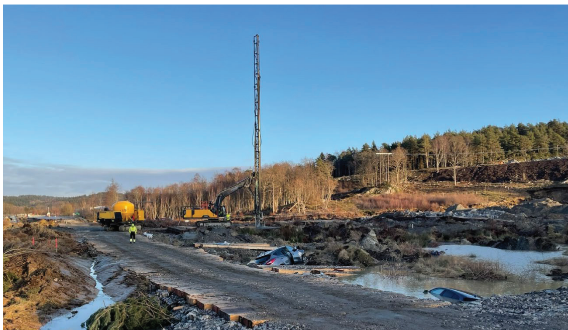
Figur 9 Foto på installation av provpelare, tagit från söder mot norr (Foto: Geotechnica)
