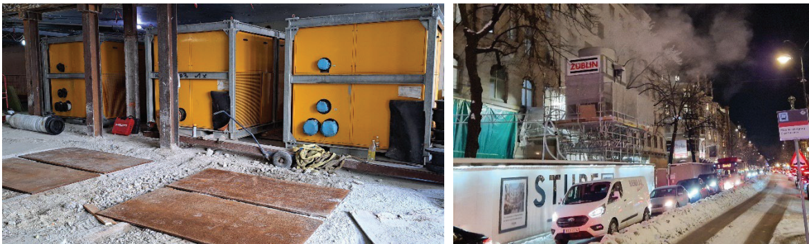
Figur 9 – Kylaggregaten (3 x 220 kW) installerades i mycket trånga utrymmen i By 41, ett stort kyltorn (1 x 1 MW) placerades utomhus på Birger Jarlsgatan.
